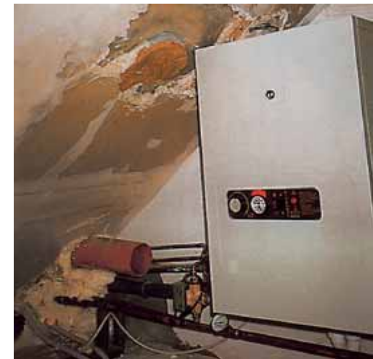
14 Panikreaktion vor dem Anrücken des Blower-Door-Teams. Eine Vielzahl von Rohrdurchdringungen mit Dosenschaum notdürftig „abgedichtet“. (quadriga, 1/2001)
