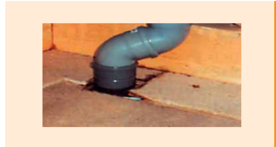
22 Fallrohrlüftung ohne „Stopfen“ auf der Durchdringung des Installations-Schachtes in den Spitzboden. Die zwangsläufige Folge: Konvektions-Tauwasser. (quadriga, 1/2001)
