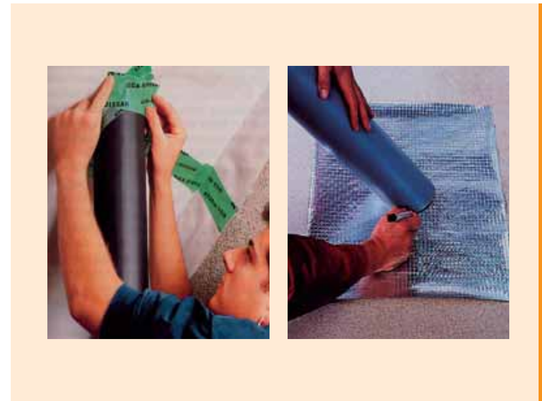
16 Die übliche Verklebung von Dichtungsbahnen mit Klebebändern ist nur gut, wenn die Öffnung der Dichtungsbahn sorgfältig vorbereitet wird. (quadriga, 1/2001)
