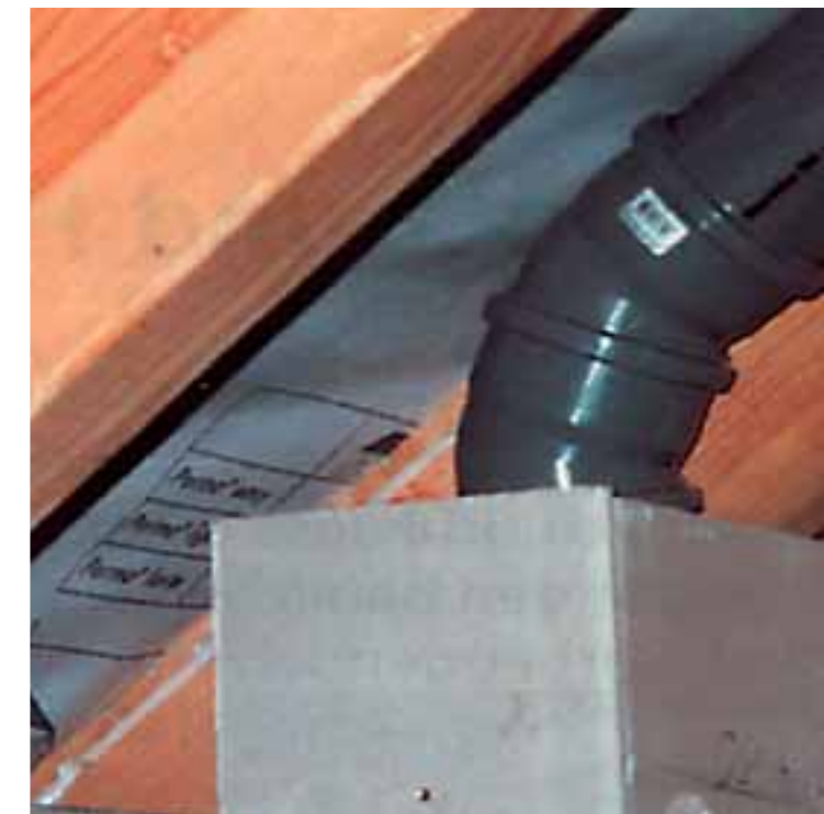
12 Installationsschacht mündet offen in der Dachschräge. (quadriga, 1/2001)
