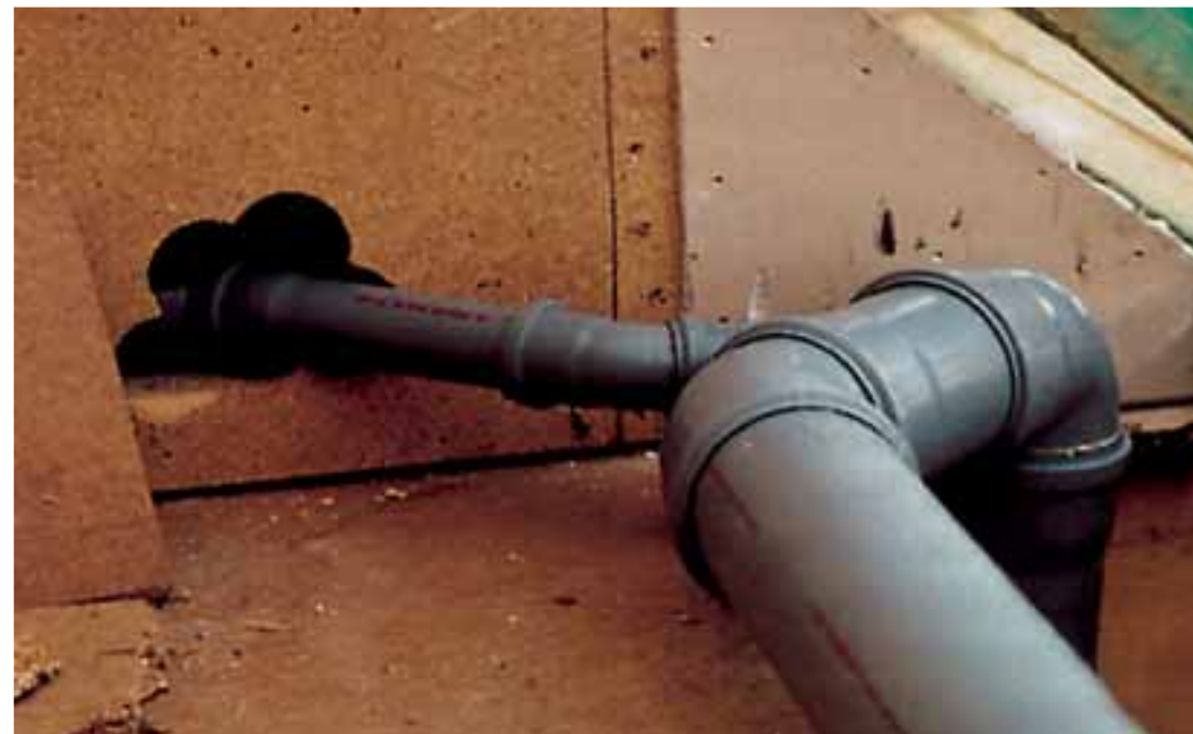
10 Preisfrage: Wo soll hier noch eine funktionstüchtige Luftdichtung eingebaut werden. (quadriga, 1/2001)
