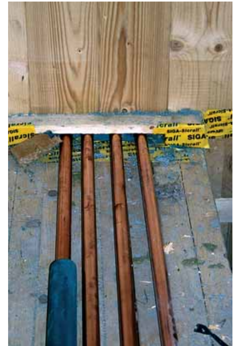
9 Unterbrechung der Luftdichtigkeit durch Installationen, die eine spätere Ergänzung erfordern! (Demonstrationszentrum Bau und Energie/HBZ Münster)
